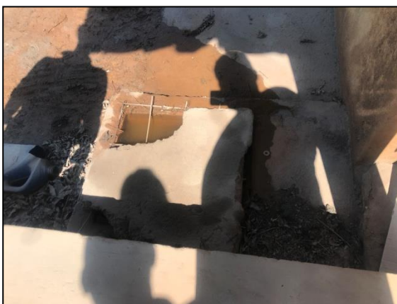
Foto 06: Caixa de contenção
