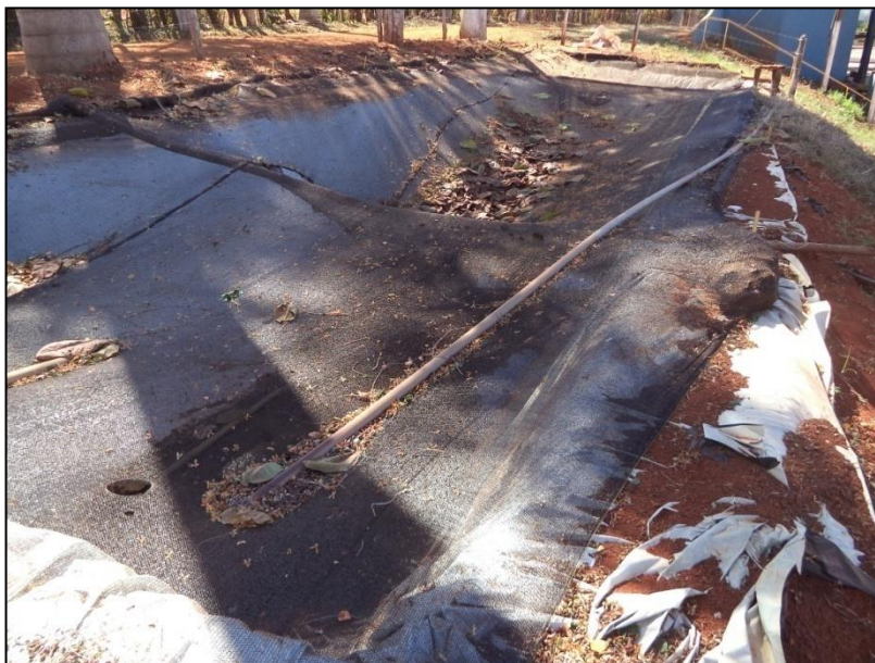
Foto 08: piscinão de decantação
