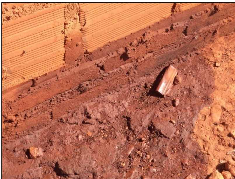
Foto 02: vazamento na bacia de contenção no ponto de abastecimento
