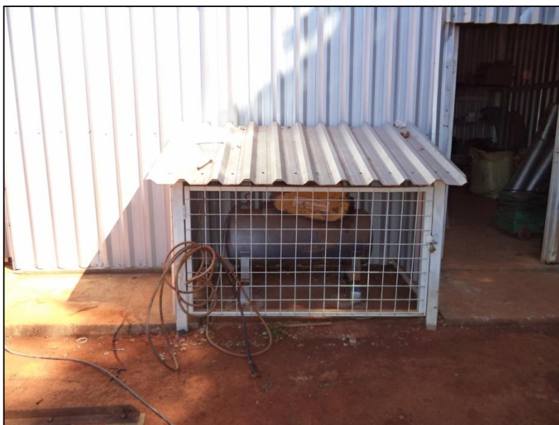
Foto 09: compressor de ar
