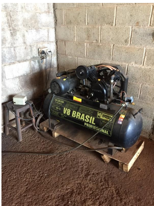
Foto 03: Compressor de ar
