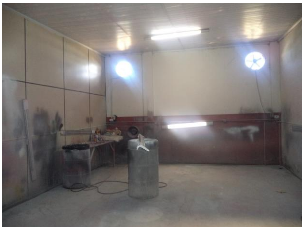
Figura 05: Cabine de pintura. Observar a presença de exaustores de ar
