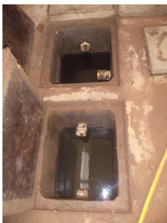
Figura 07: Caixa separadora de água e óleo
