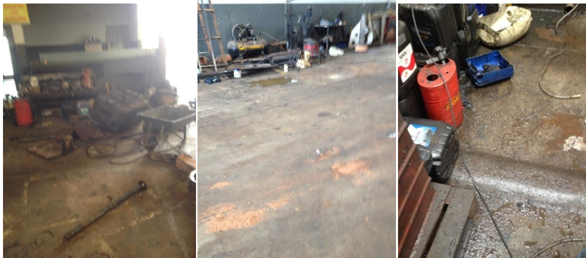
Fotos de 01 a 03: Vista geral do galpão - local de trabalho, observar no piso – serragens onde houve vazamento de óleo e o piso com óleo próximo à Caixa Separadora de Água e Óleo.
