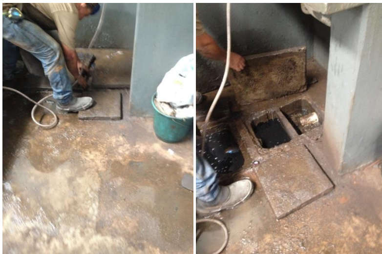
Fotos 05 e 06: Caixa Separadora de Água e Óleo
