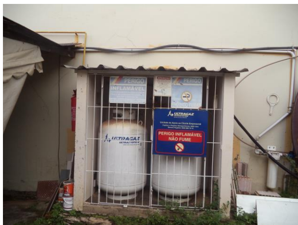
Figura 13: Armazenamento dos botijões de 180 kg/cada
