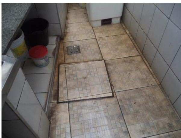
Figura 09: Caixa de gordura
