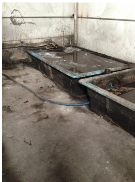
Foto 10: Caixas finais: efluentes finais.
