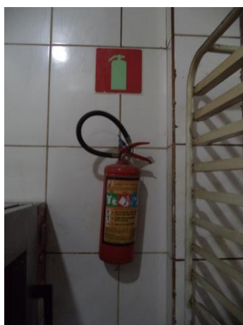
Figura 20: Extintor de incêndio
