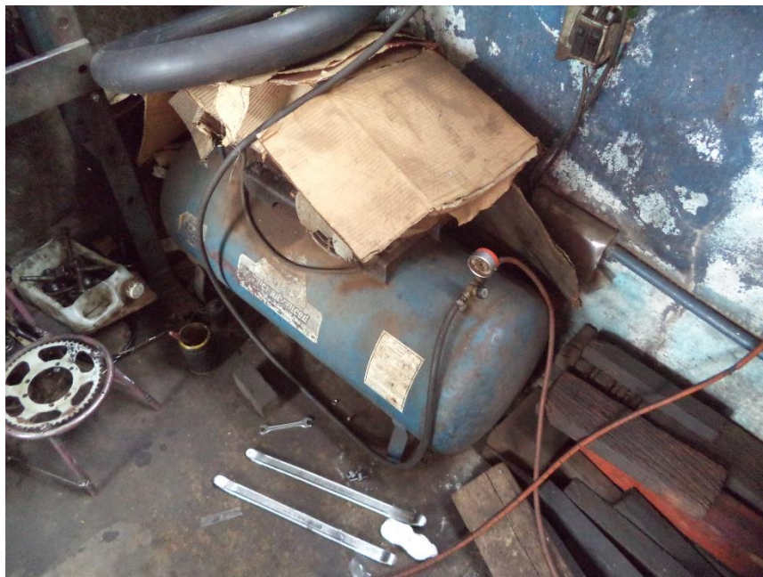
Foto 6: Compressor de ar
