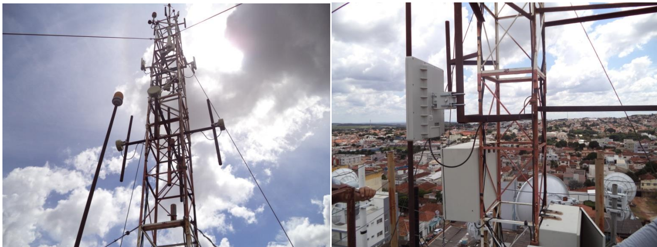
Fotos 01 e 02: Antena de transmissão
