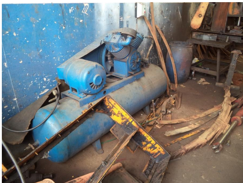
Figura 5: Compressor de ar
