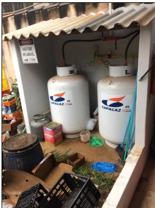
Foto 03: Área de estocagem dos cilindros de gás
