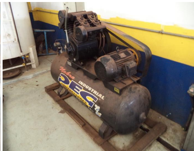
Figura 10: Compressor de ar
