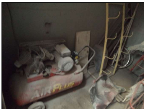
Foto 05 – Compressor de ar
